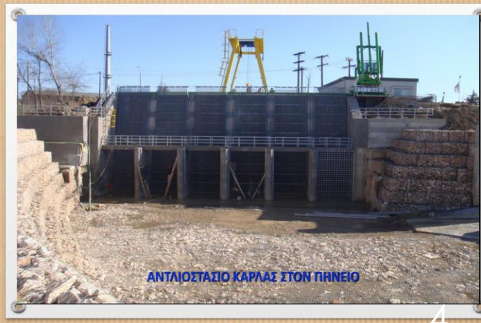
ΑΝΤΛΙΟΣΤΑΣΙΟ ΣΤΟΝ ΠΗΝΕΙΟ ΓΙΑ ΤΗΝ ΜΕΤΑΦΟΡΑ ΝΕΡΟΥ ΣΤΗΝ ΚΑΡΛΑ
