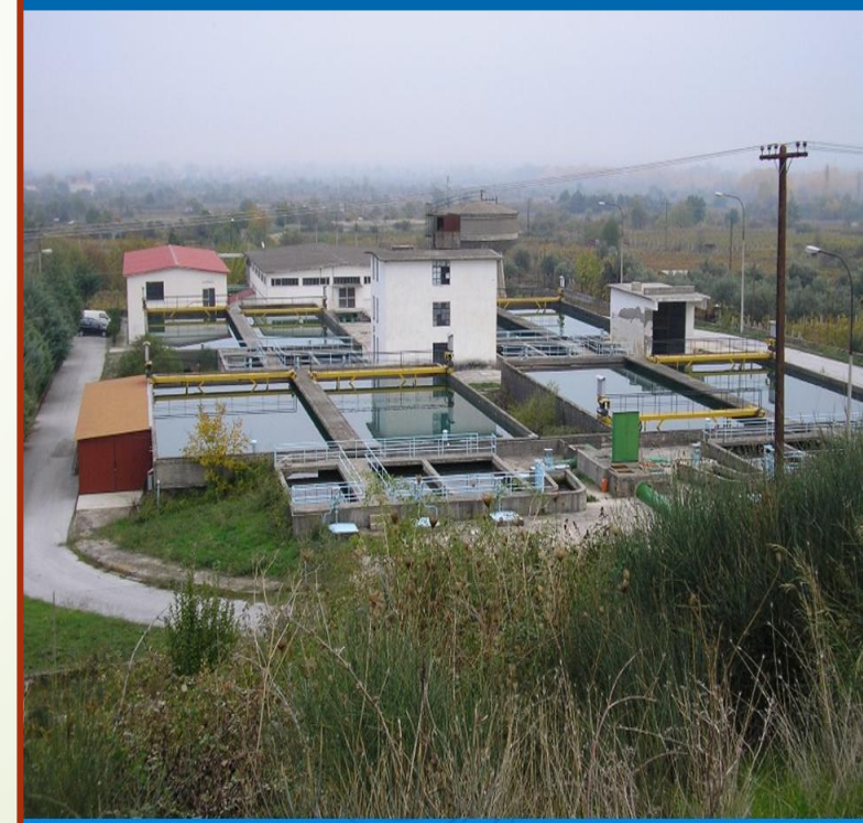
Διυλιστήριο Νερού Συνδέσμου Ύδρευσης Καρδίτσας
