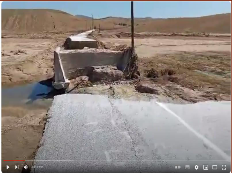
Ο κατεστραμμένος δρόμος από Ζάππειο προς Μύρα-Σοφό-Καλό Νερό
