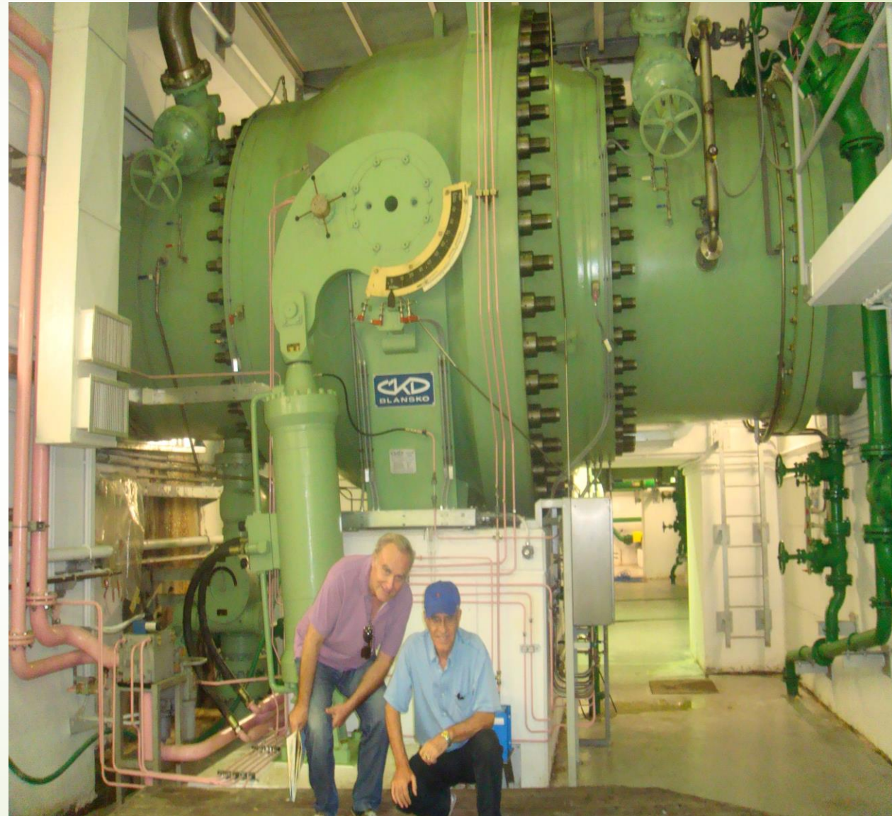
Εσωτερικό ΥΗ Σταθμού Γλύστρας Μεσοχώρας
